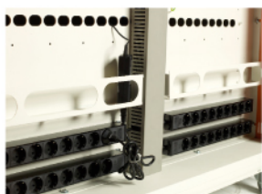
Bahías de conexión eléctrica
