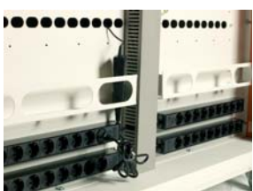
Bahías de conexión eléctrica
